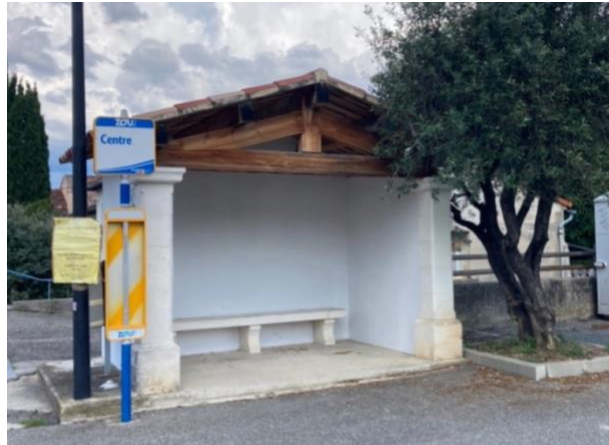
Peinture temporaire de l'abri bus vandalisé.
