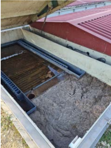
Figure 22: Décanteurs lamellaires de la STEP de Roaix
