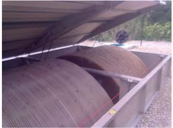
Figure 23: Biodisques à la STEP de Roaix (Source : Tramoy)
